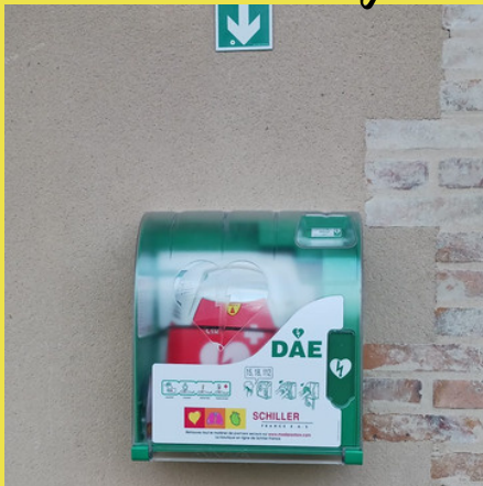
Défibrillateur installé au niveau de la salle des fêtes
